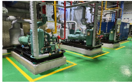
2023.4 고효율 냉동기 설치 [투자효과] 고효율 설비 도입으로 에너지 절감 / 온실가스 감축
